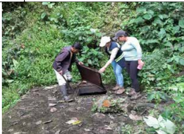
Captación del estero S/N en mal estado de la Junta de Agua Potable Tagualó
