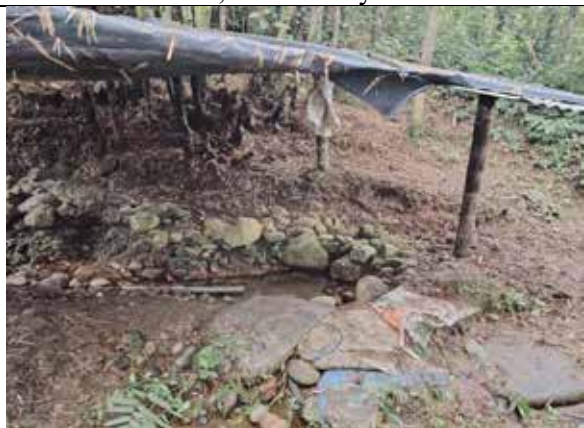
Captación de la vertiente Isla de Puenbo, Pre Junta Administradora de Agua Potable "Fuente de Vida"
