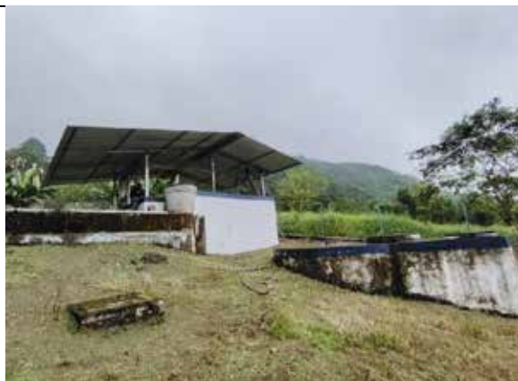
Planta de tratamiento 2 de la Junta Administradora de Agua Potable El Palmar, California y Tilinche
