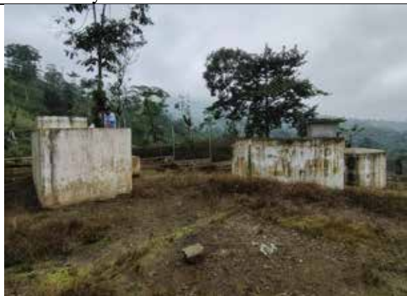
Planta de tratamiento de la Pre Junta Administradora de Agua Potable "Bendición de Dios"
