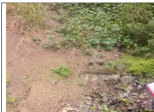
Captación del estero Patiño de la Junta Administradora de Agua Potable El Tingo La Esperanza
