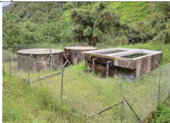
Planta de tratamiento de agua de la Junta Administradora de Agua Potable El Tingo La Esperanza que funciona como tanque de almacenamiento
