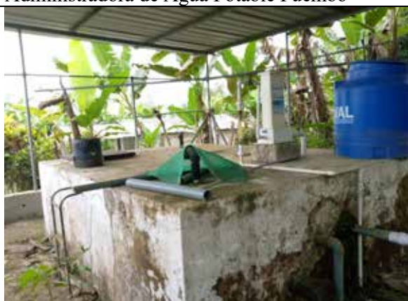
Tanque de cloración sin uso de la la Junta Administradora de Agua Potable Puenbo
