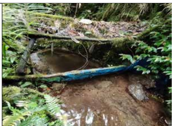
Captación de la vertiente San Jerónimo de la Junta Administradora de Agua Potable El Tingo La Esperanza
