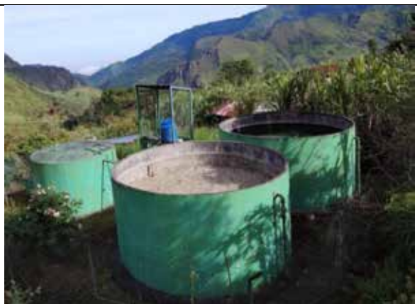
Planta de tratamiento de agua de la Junta de Agua Potable Tagualó
