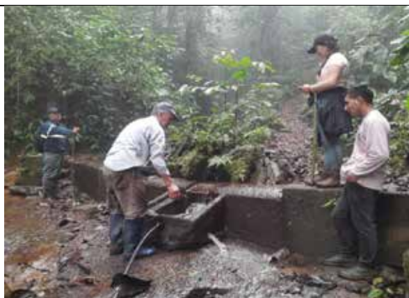
Captación de la vertiente S/N de la Junta Administradora de Agua Potable El Palmar, California y Tilinche
